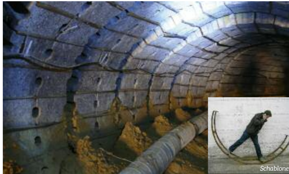
Die Ausmauerung hat dem Druck des überlagernden Tones standgehalten
